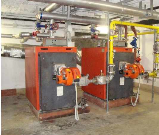
Figura 4.11 - Particolare generatore di calore
