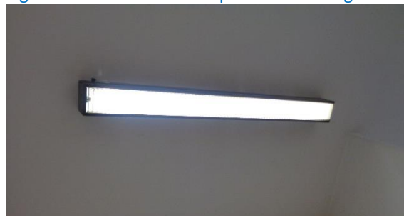
Figura 4.14 - Particolare corpi illuminanti bagni
