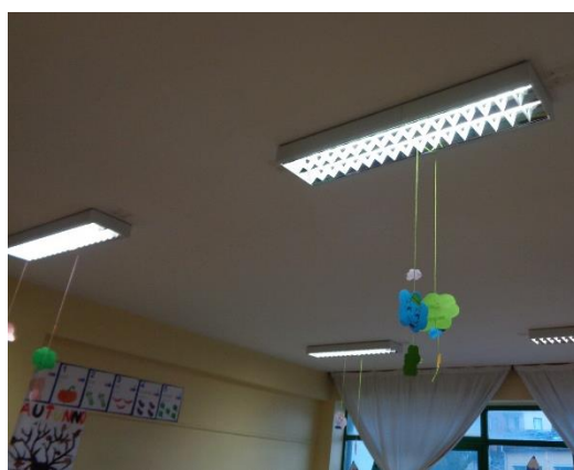
Figura 4.15 - Particolare dei corpi illuminanti ubicati nelle aule
